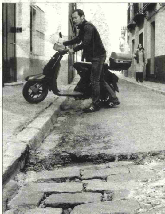
DESPERFECTOS. Los baches son frecuentes en calles como San Luis.
